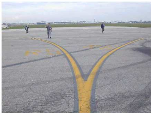
Bivio R5-R6 in condizioni normali (notare le scritte fuori norma)
